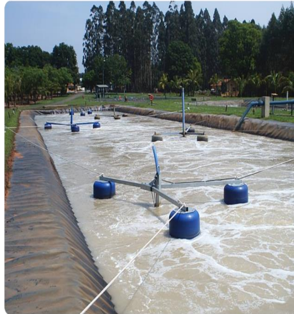
Tratamento de Efluentes
