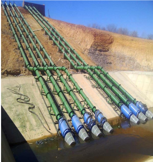
Sistemas de Bombeamento
