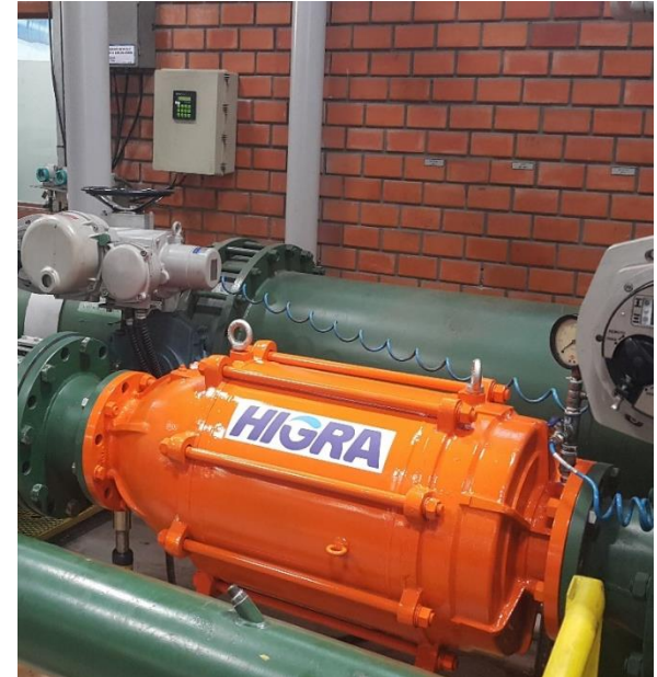
Geração de energia
